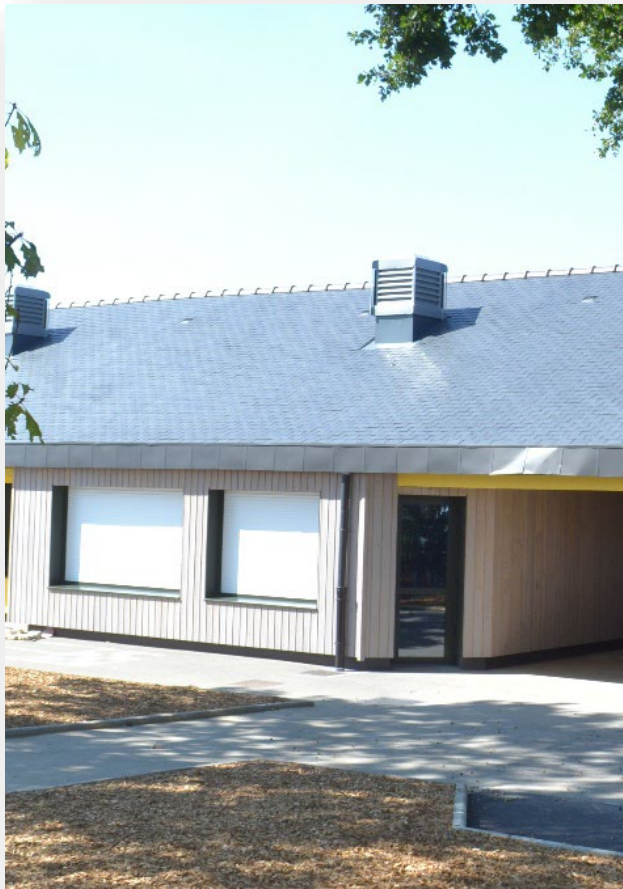
Tourelle ventilation naturelle en rénovation d'un groupe scolaire à Retiers
