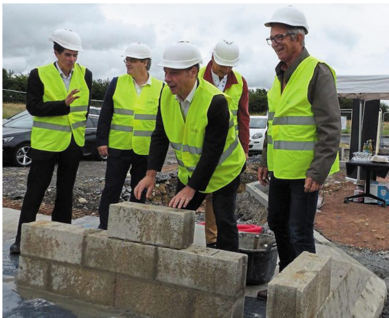
Christophe Martins, président de Montfort Communauté, pose symboliquement première pierre de la station accompagné de Fabrice Dalino, maire de Montfort, Daniel Guillotin et Olivier Dehaese du Syndicat départemental d'énergie, et de Jean Ronsin, élu de Bédée.
