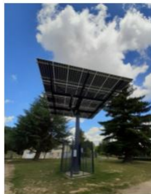
Placé sur un poteau pivotant de 3,5 mètres de haut, le tracker compte 75 m 2 de panneaux solaires permettant de produire 19 MWh par an. ©Énerg'iv.
